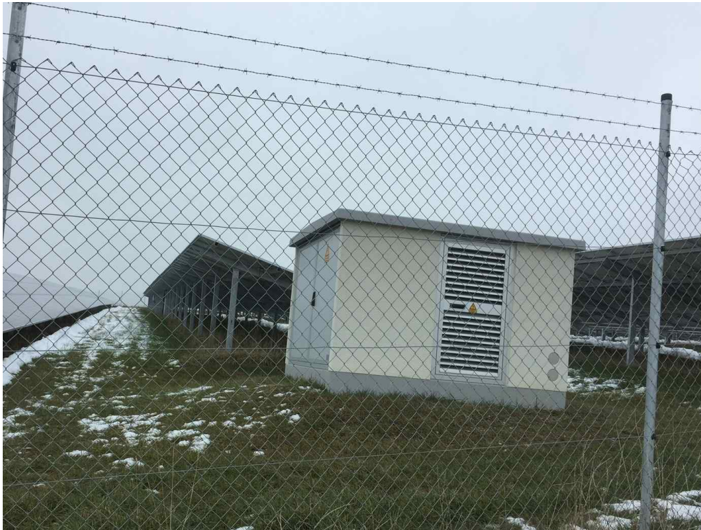
Trafostation einer gleichartigen Photovoltaik-Freiflächenanlage. Je 1 ha Anlage ist mit einer Trafostation zu rechnen. Der Trafo ist deutlich niedriger und schmaler als die Modultische .
